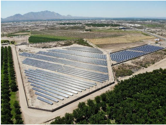
Ubicación de Bachimba , 12 instalaciones fotovoltaicas Se utilizaron FIMER PVS-120 y Trio.
