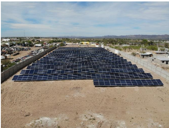
Saucillo ciudad , 1 instalación fotovoltaica con PVS-120.
